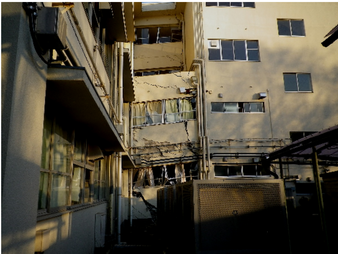
新聞報道のとおり栄小学校の北校舎が沈下、本校舎との連結部が大きく損壊した。
